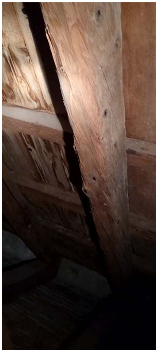
8. Konstrukcija krovišta: grede, rogovi, gredice. Vidljiva oštećenja oplata (središnji dio, SZ krovna voda)
