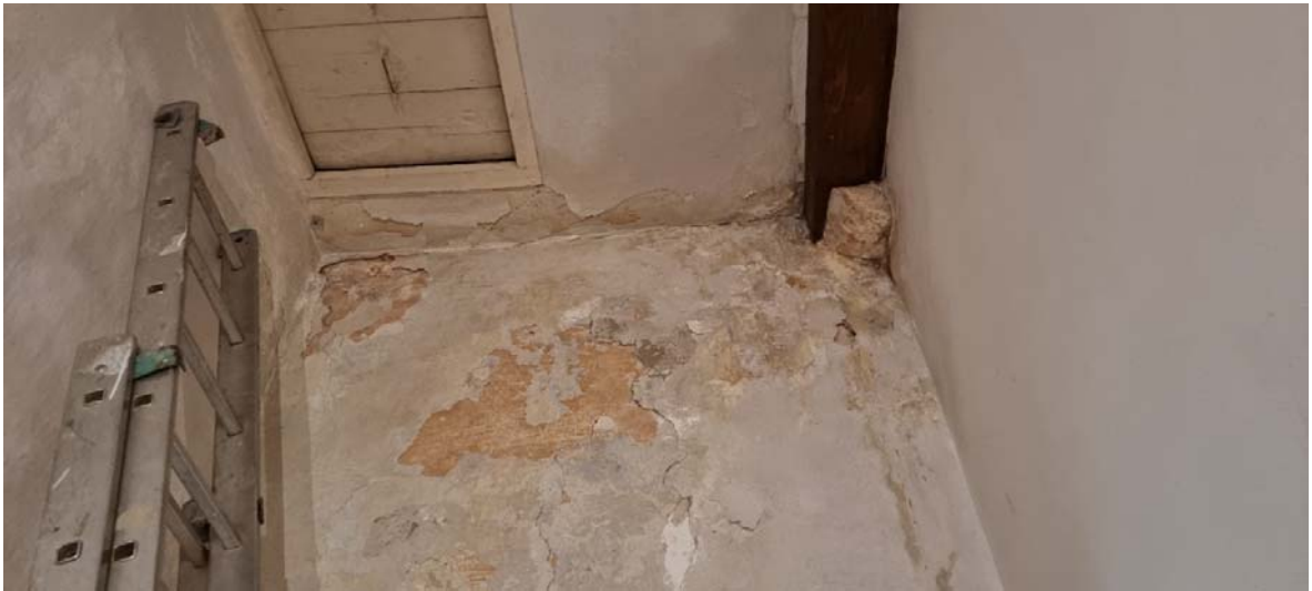
13. Oštećenja od vlage, soba 9, prvi kat. Vidljiva purtela prema tavanu
