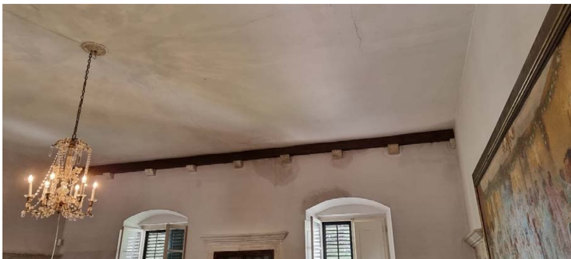
10. Vlaga u zoni podgleda, soba 11, prvi kat, interierska strana SZ pročelja
