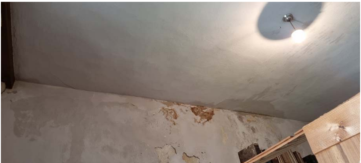
14. Oštećenja od vlage, soba 10, prvi kat
